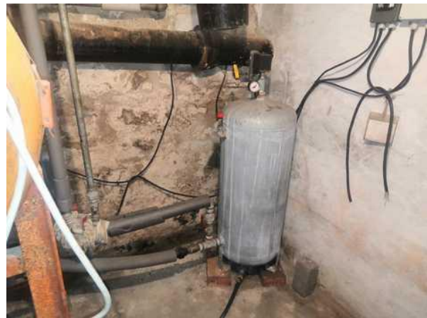
domácí vodárna v I.PP
