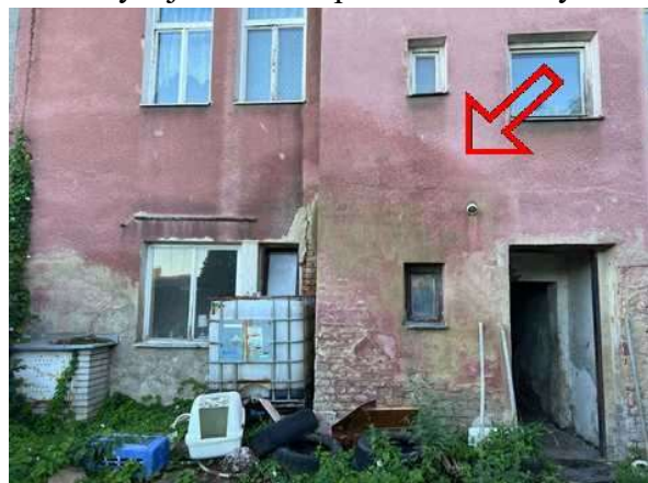
viditelná vlhkost zdiva v úrovni 1.NP
