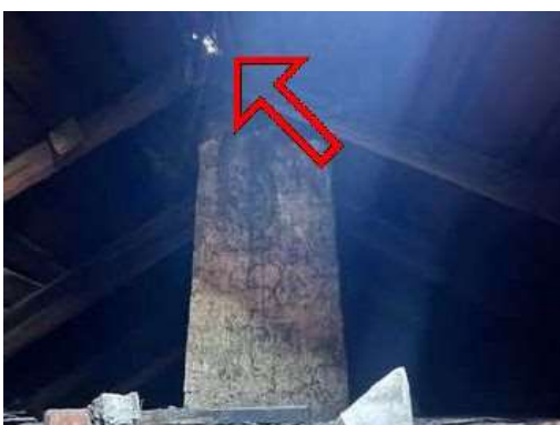
poruchy střešního pláště
