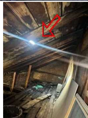
poruchy střešního pláště
