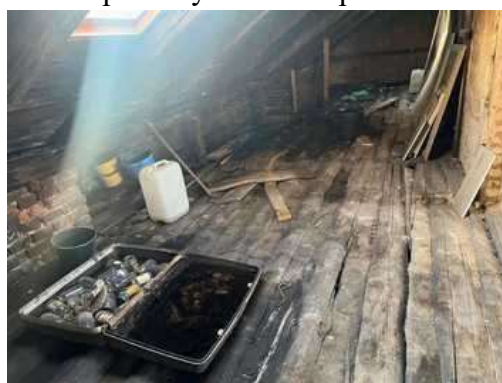
zvlhlý povrch z důvodu zatékání
