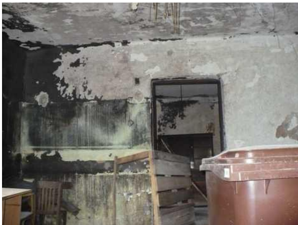
poškozené zdivo a omítky
