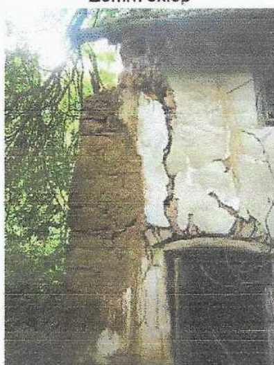
Narušená statika RD
