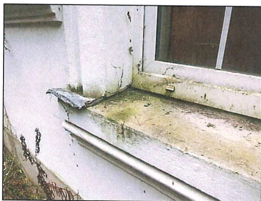
detail chybějícího parapetu
