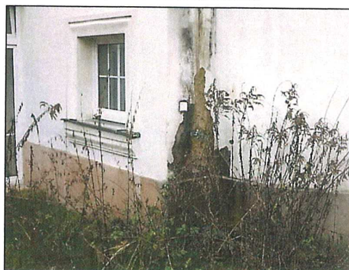
zatékání dešť. vody do nosných konstrukcí
