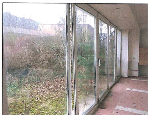
1.PP – nefunkční okno
