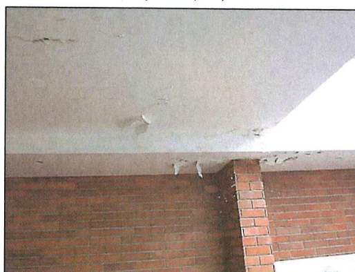
opadávání malby u bazénu
