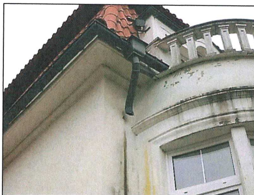
chybějící okapový svod
