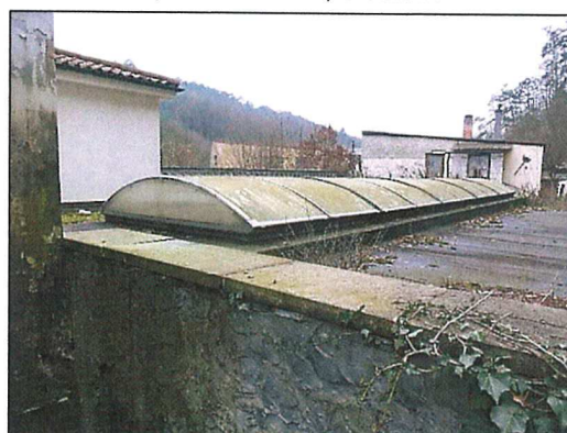
střecha bazénu a vlkost ve zdivu (vlevo)
