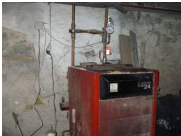
kotel ÚT na TP
