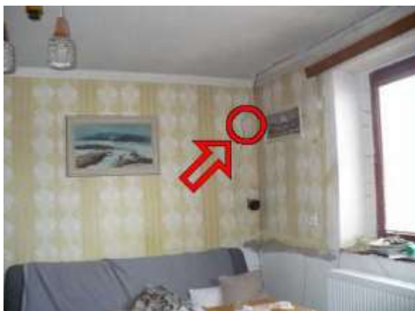
ložnice s narušeným zdívem - SZ roh RD
