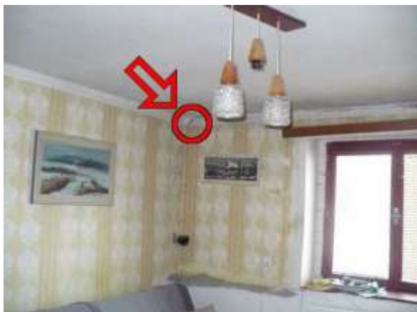
ložnice se staticky narušeným zdivem
